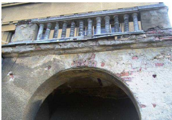
Příloha 13 Havarijní stav terasy domu č.p. 435-II. Zdroj: autor
