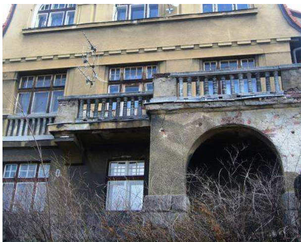
Příloha 12 Havarijní stav terasy domu č.p. 435-II. Zdroj: autor
