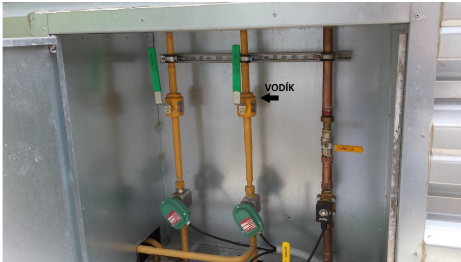
Obr. 11 Hlavní uzavírací ventily
