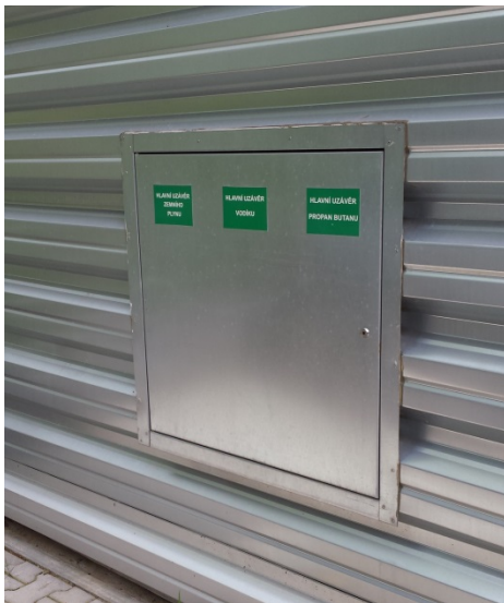
Obr. 10 Skříň hlavních uzavíracích ventilů
