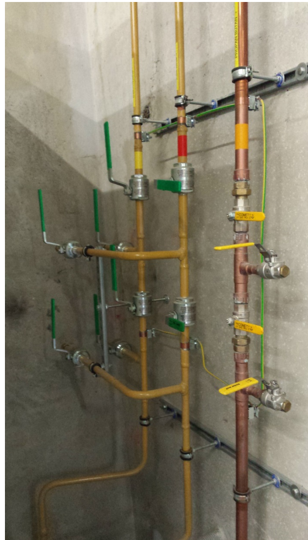
Obr. 9 Uzavírací ventily v budově
