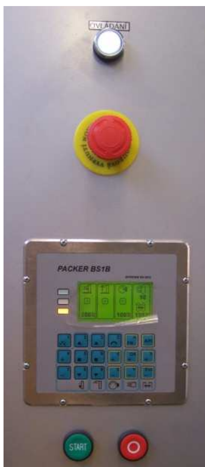
Obr. 8 Čelní část rozvaděče s ovládacími prvky
