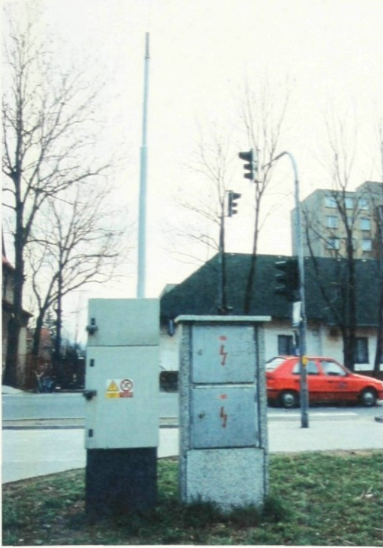
Obr.č. 1: Kontrolní bod (přenos dat) ve Zlíně
